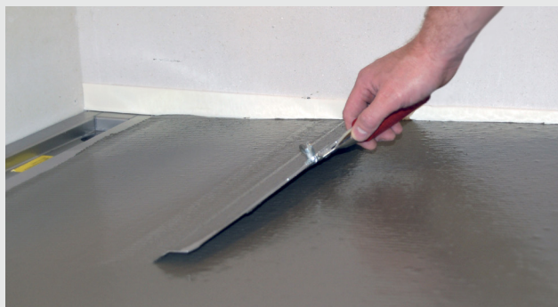
Falloppbygging ved veggært sluk
